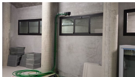
Vista interna. Dettaglio attraversamento cavi
